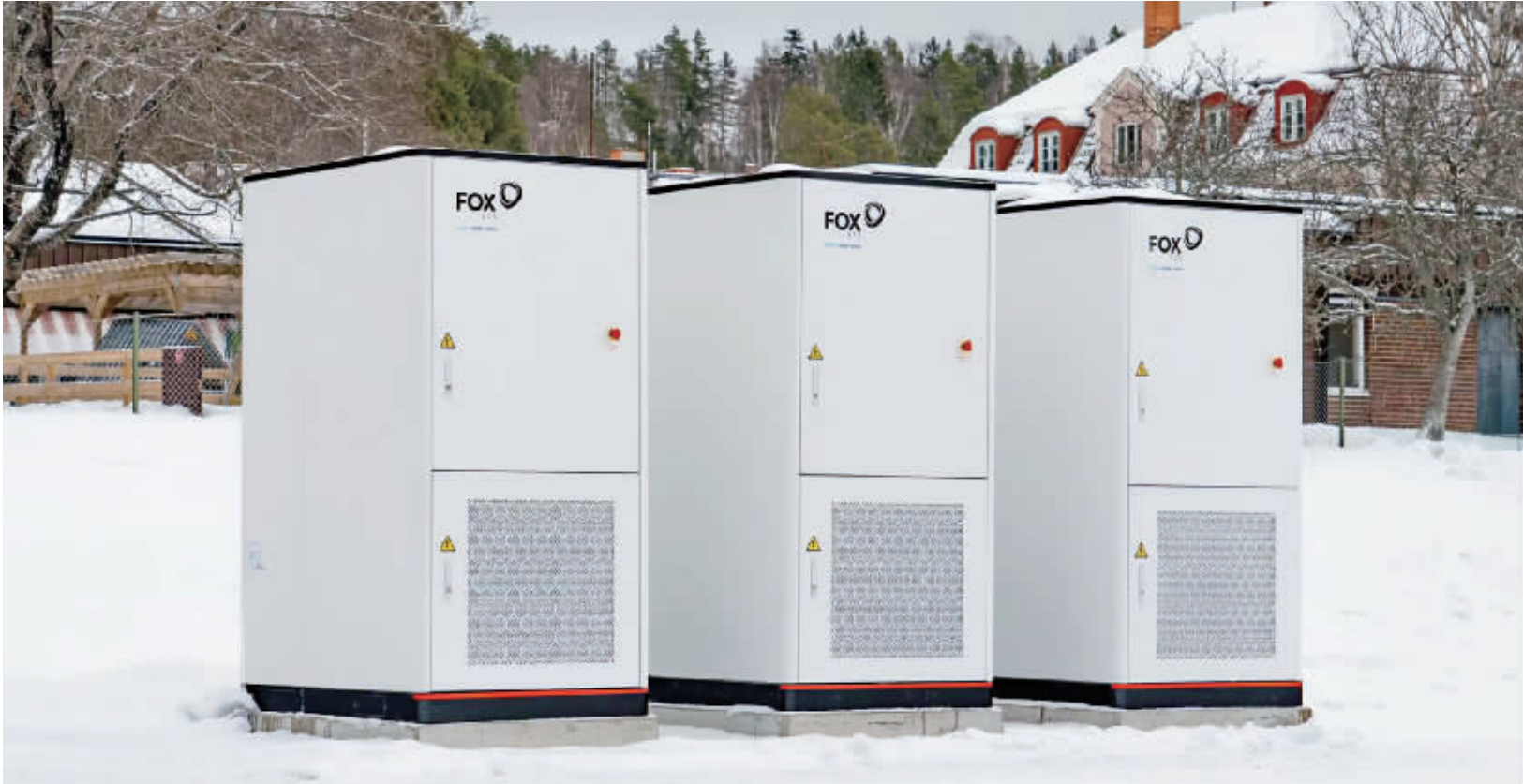
图为瑞典Grycksbo小镇的充电站，部署三台100kW/215kWh的G-Max储能设备。公司供图
