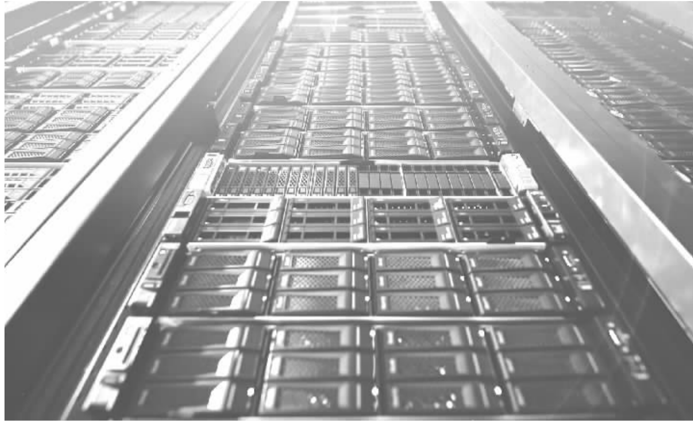
远景赤峰零碳产业园内的AIDC机柜
