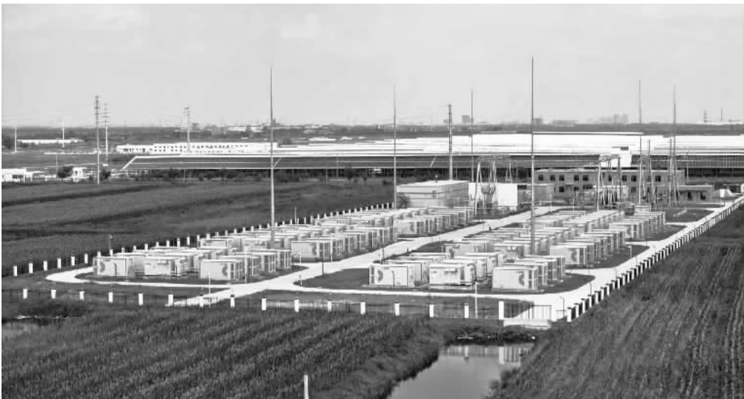
天合储能中核寒亭独立储能项目
