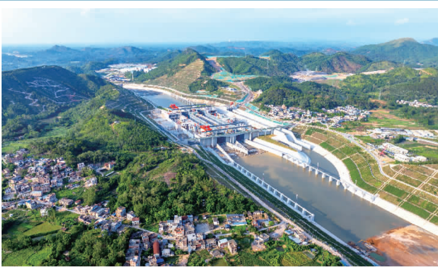
这是6月3日拍摄的广西平陆运河马道枢纽充水现场(无人机照片)。
