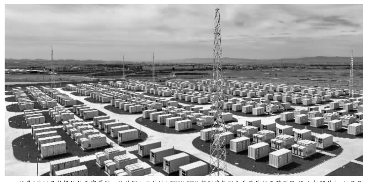
这是5月19日拍摄的位于宁夏同心县的同心县妙岭1GW/2GWh新型绿电混合共享储能示范项目(无人机照片)。该项目目前已并网投入使用。
