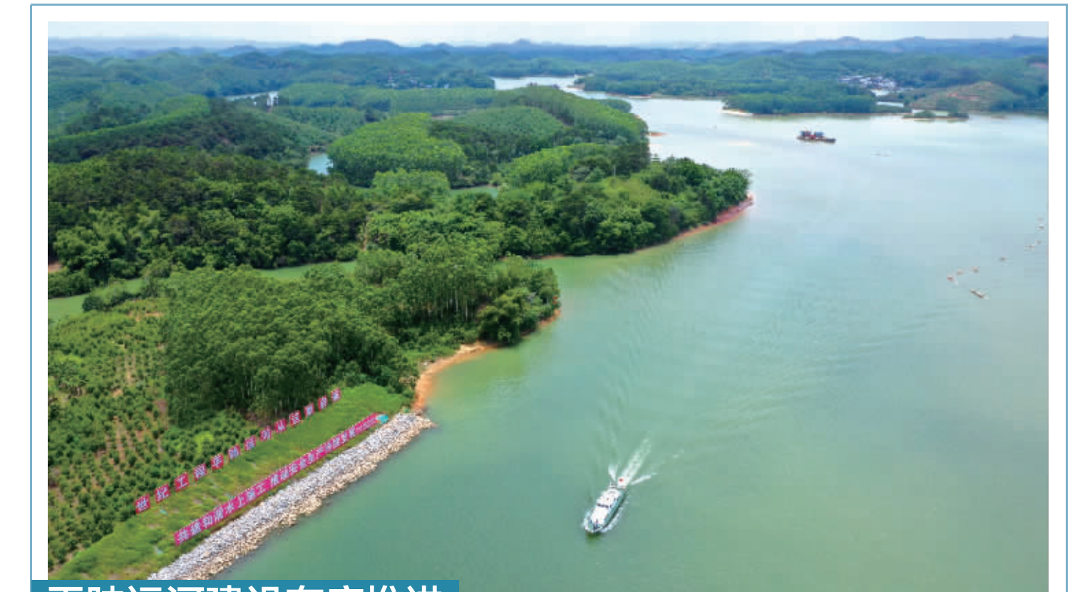
平陆运河建设有序推进 这是广西平陆运河平塘江口（无人机照片，5月13日报）。平陆运河是西部陆海新通道骨干工程，全长134.2公里，可通航5000吨级船舶。目前，平陆运河整体工程建设有序推进，计划今年9月通航，建成后将打通中国西南地区经西江干流南下入海的江海联运大通道。新华社记者 陆波岸 摄
