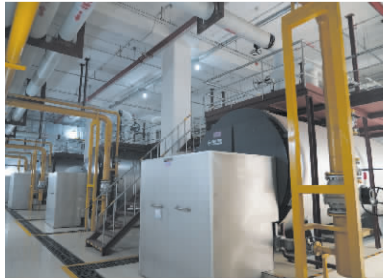
金房能源位于北京京城雅苑供热项目
