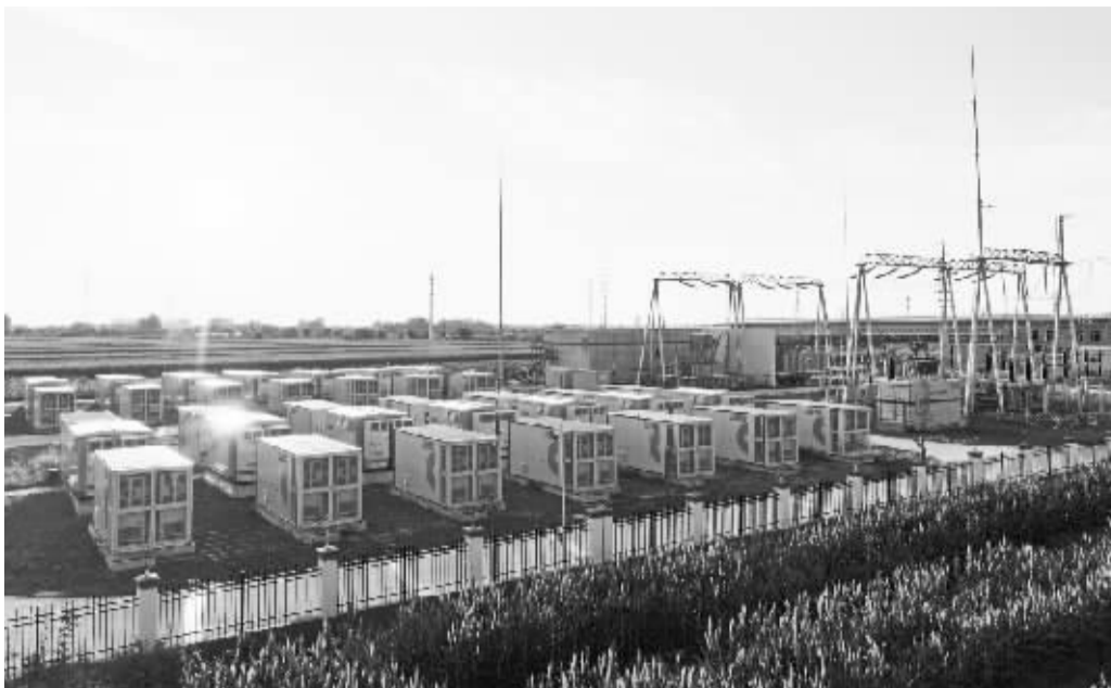
天合储能中核寒亭独立储能项目
