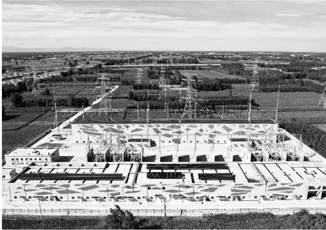
雄安东500千伏超高压变电站
