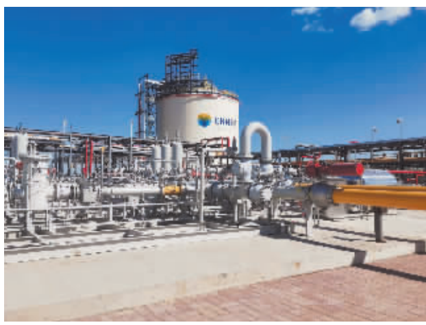
新奥股份位于廊坊经济技术开发区的LNG储气站 本报记者 刘杨
