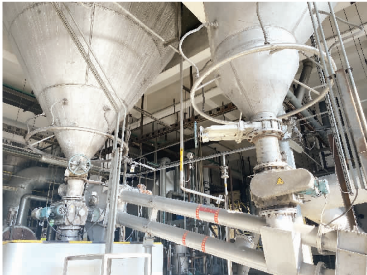
浙江恒逸聚合物有限公司生产车间
