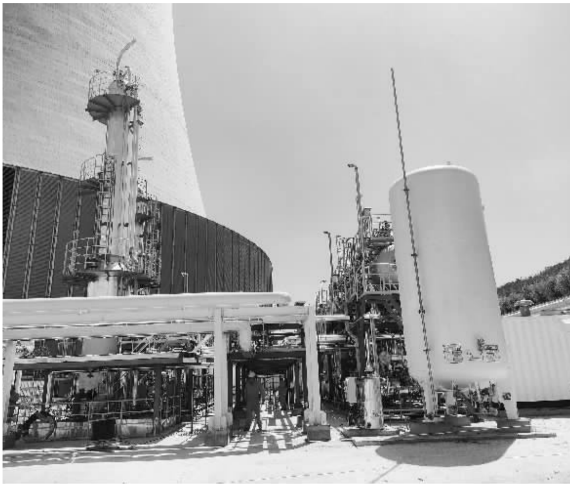
500吨/年二氧化碳电解制合成气项目现场
