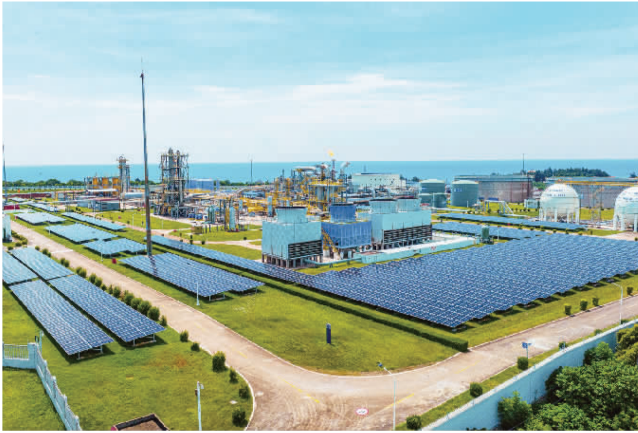
涠洲油田群光伏电站
