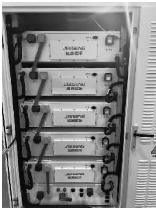
极晟能源采用三代浸没式液冷冷却系统的储能柜 本报记者 张韵 摄
