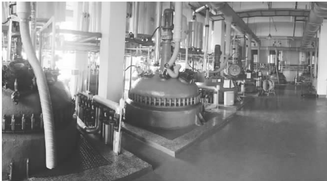
哈一药业车间设备
