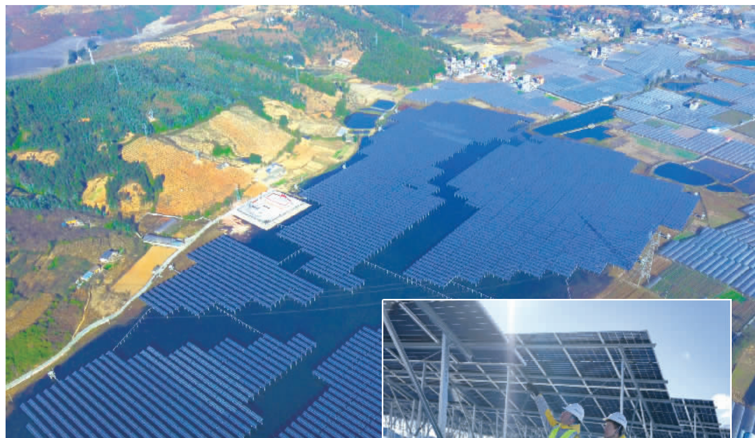
▲ 通威股份四川西昌“渔光一体”项目。通威股份供图 ▶ 柯拉光伏电站项目建设现场。雅砻江流域水电开发有限公司供图
