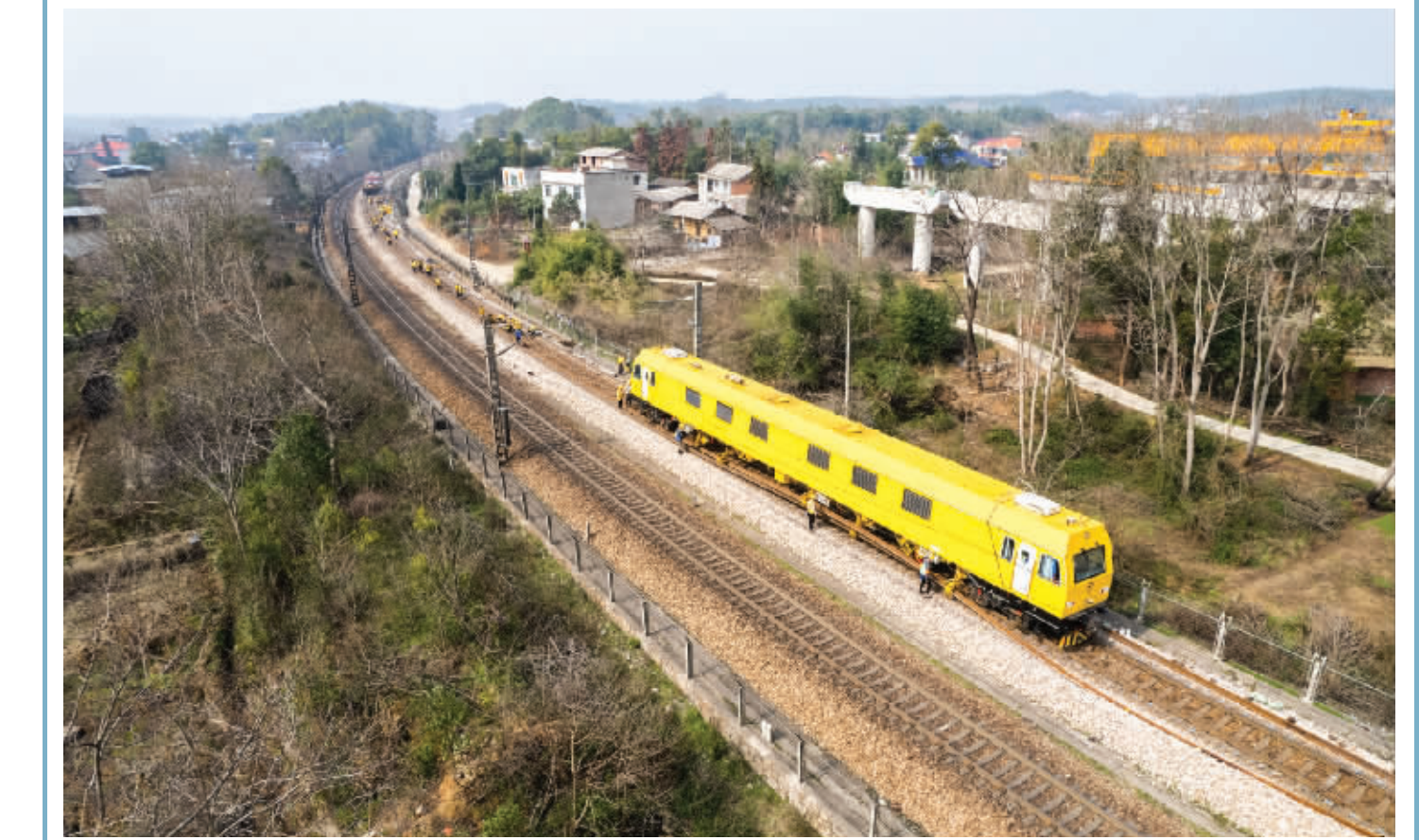
沪昆铁路换轨施工忙 2月19日，在沪昆铁路娄底至湘潭东区间，一辆快速换轨车正在施工（无人机照片）。近日，在沪昆铁路娄底至湘潭东区间，广铁集团广州工务大修段工人在不影响线路运行的情况下，抓紧时间对线路进行换轨施工。本次施工预计3月底完工。 新华社图文
