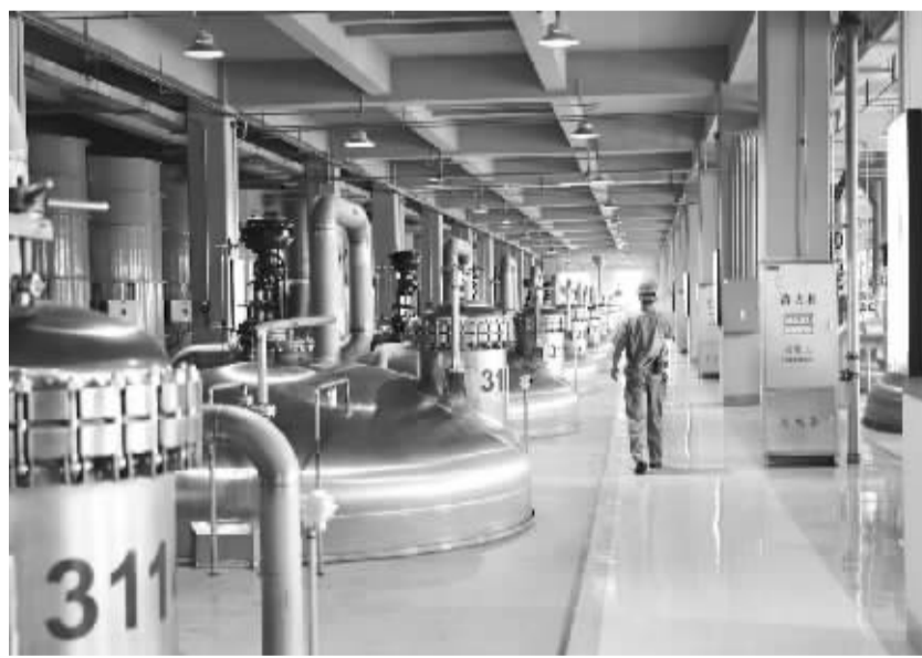
东北制药维生素C生产线
