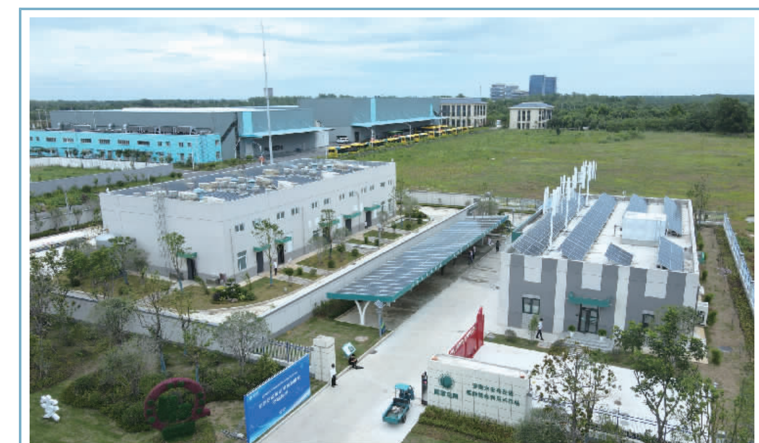
国内首座兆瓦级氢能综合利用示范站投运 这是7月6日拍摄的安徽六安兆瓦级氢能综合利用示范站(无人机照片)。当日,国内首座兆瓦级氢能综合利用示范站在安徽六安投运,标志着我国首次实现兆瓦级制氢-储氢-氢能发电的全链条技术贯通。 新华社图文
