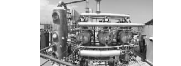
宁波市海曙区水质净化厂
