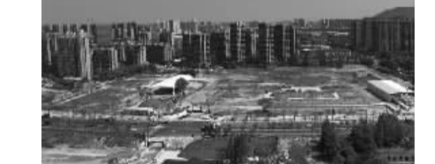
绍兴市漓源水质净化厂
