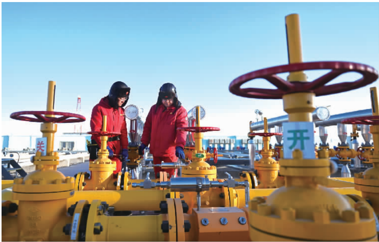
在中国石油天然气集团公司青海油田公司采气一厂，工人在检查输气管道。据国资委消息，今年1月，中国石油集团积极应对疫情、国际形势和油价变化，超前研判市场，强化一体化运作，深入推进提质增效，确保了油气两大产业链安全平稳运行，经营业绩实现了2022年首月“开门红”。
