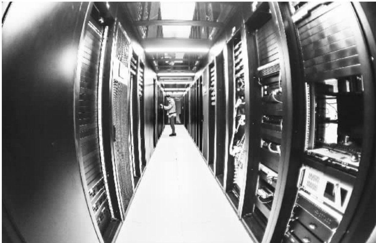
工作人员在“一码贵州”数据平台机房检查设备运行情况。
