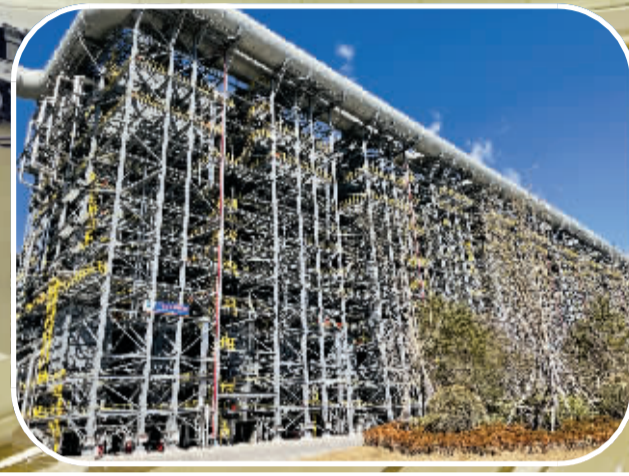
恒力石化乙烯项目装置
