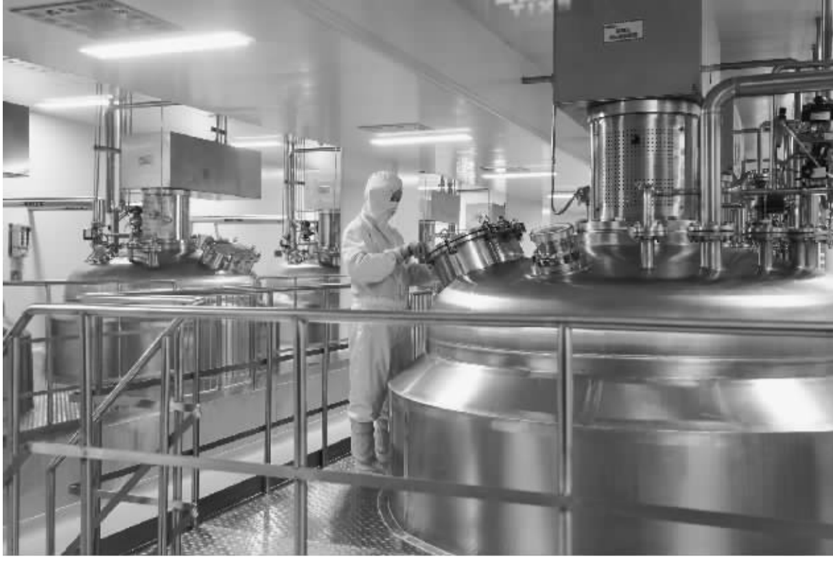
东北制药维生素C原料药生产线
