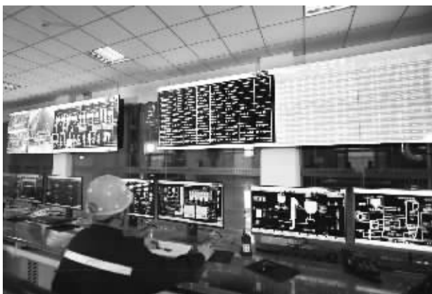
联美控股旗下供热子公司主控室
