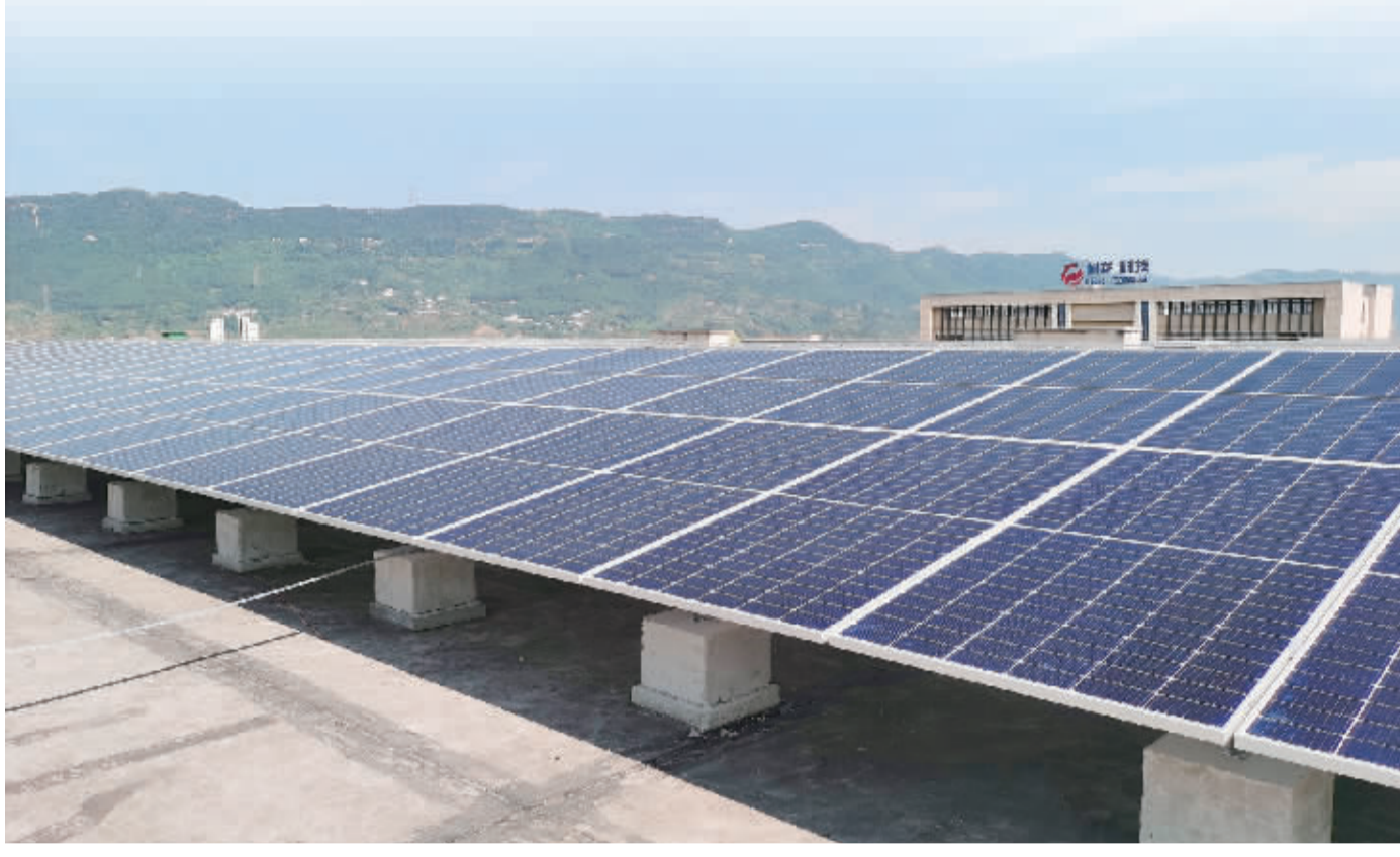
广安爱众为客户投建的光伏项目 公司供图
