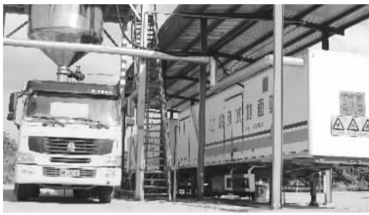
混装炸药地面站
