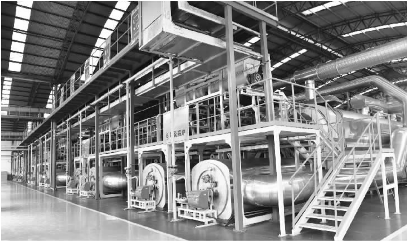
恒誉环保的客户废轮胎裂解生产线运行现场
