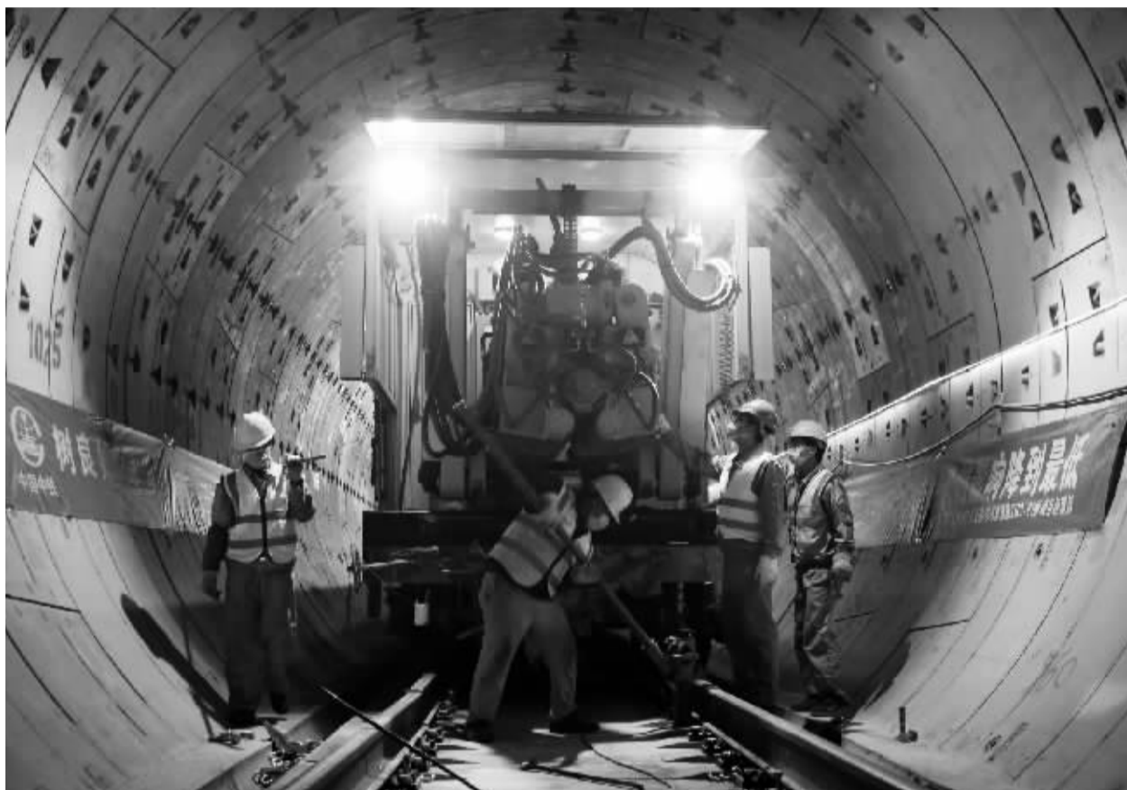
4月1日,工人在江苏常州地铁2号线隧道里施工。近期,江苏常州地铁2号线加快推进工程建设,铺轨工作24小时进行。 新华社图文
